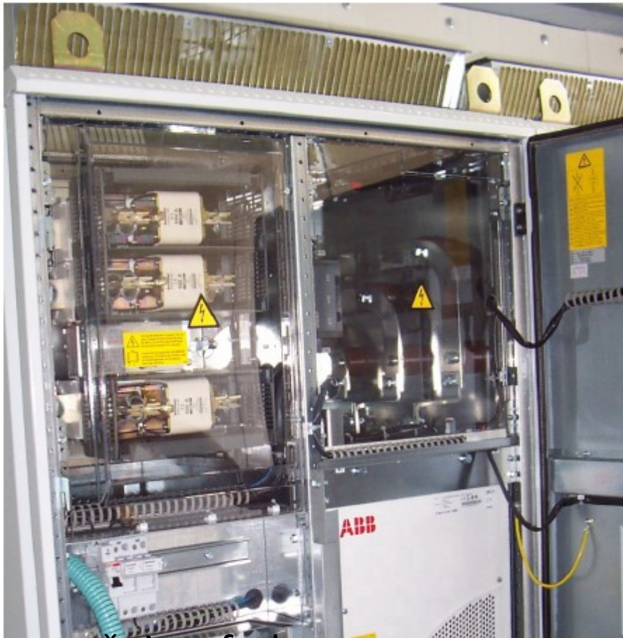
Unutrašnjost frekventnog pretvarača
